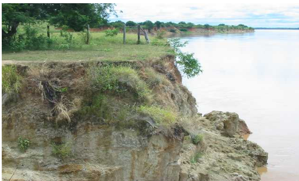
Figura 17 – Erosão na margem do rio – Comunidade Estreito Fonte: ATES (2006)
